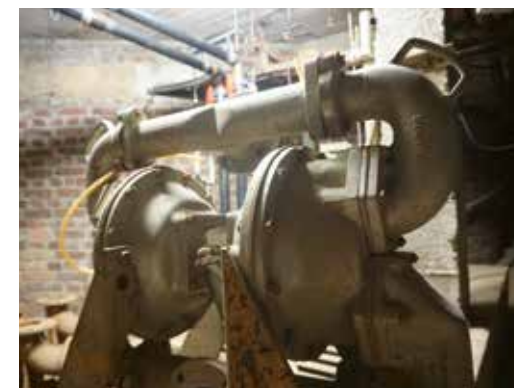
Les pompes de rabattement de la nappe phréatique dans les sous-sols du musée des Arts et Métiers. Elles permettent d'éviter l'inondation des amphithéâtres en maintenant l'eau sous les bâtiments.
